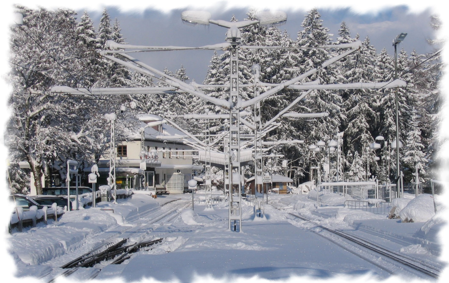
Backer Wolff Weichenheizung im Bahnhof Eibsee am Fuß der Zugspitze
