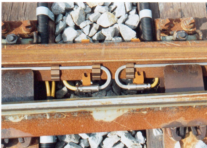
Backenschienenheizung ( z.T. auch Beheizung der Zungen- vorrichtung genannt ) in einer Vignolschienen-Weiche montiert mit Anschlusskopfbefestigung (neue Anschluss Technik)
