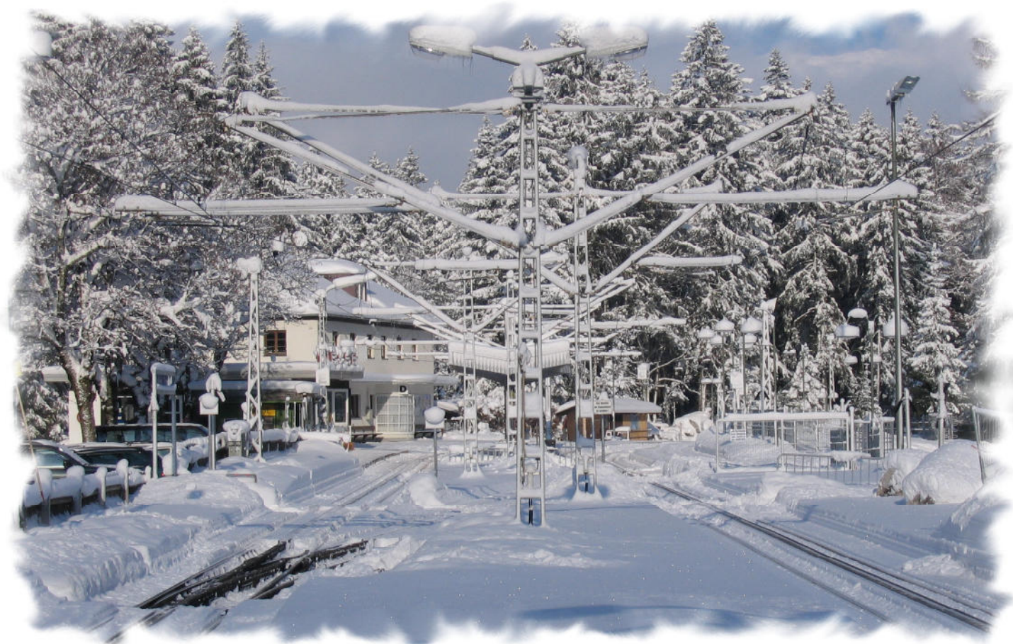
Wolff Weichenheizung im Bahnhof Eibsee am Fuß der Zugspitze
