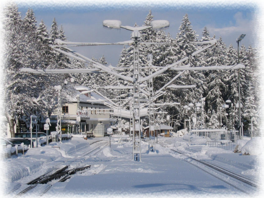
Wolff Weichenheizung am Bahnhof Eibsee am Fuß des höchsten deutschen Berges der Zugspitze Bild mit freundlicher Genehmigung von der Bayrischen Zugspitzbahn
