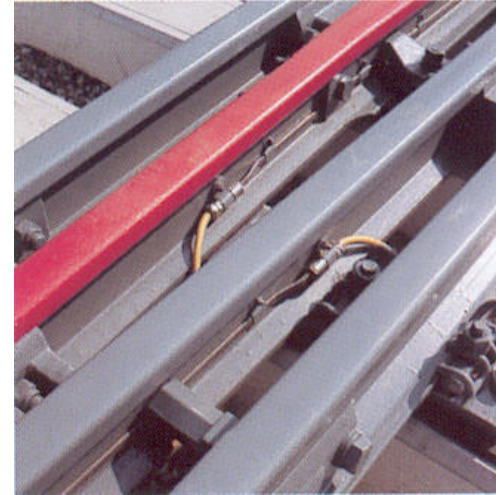
Heizstäbe in federnd beweglichen Herzstücken UIC 60 - 10000/4000 an der Schnellfahrstrecke Madrid - Sevilla
